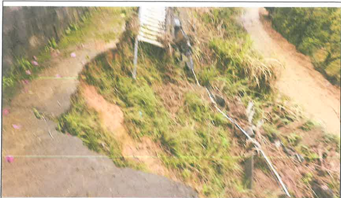
照片9 挡墙完全损毁
