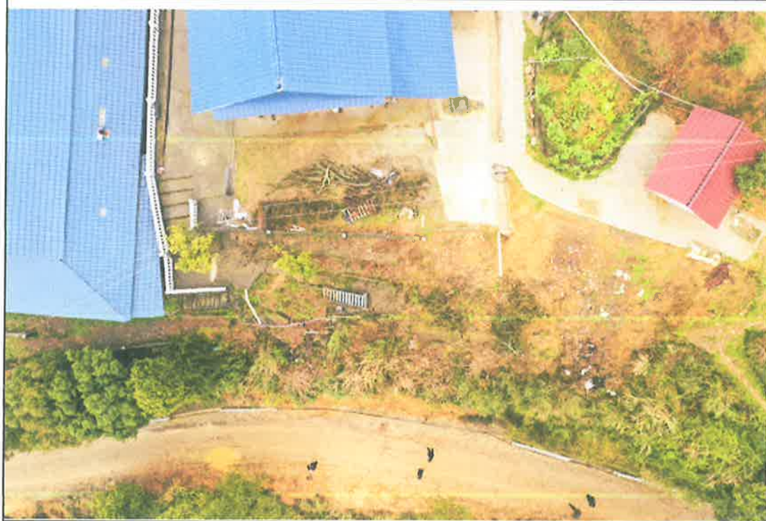
照片4 隐患点俯视图（2026年摄）
