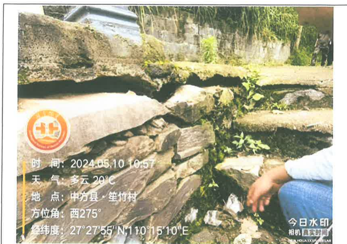
照片7 挡墙下沉
