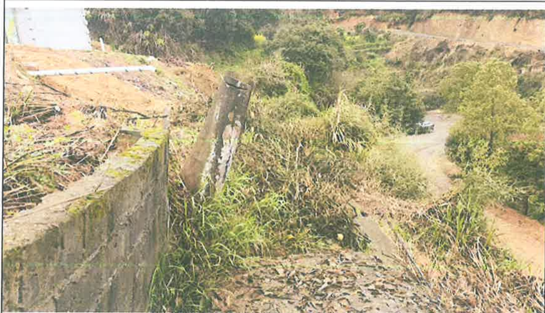
照片10 挡墙上部树木滑移
