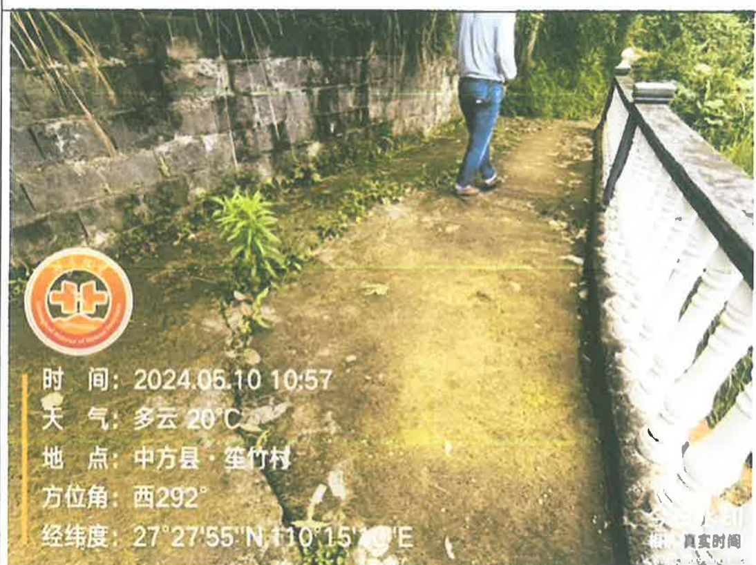
照片5 挡墙上部裂缝
