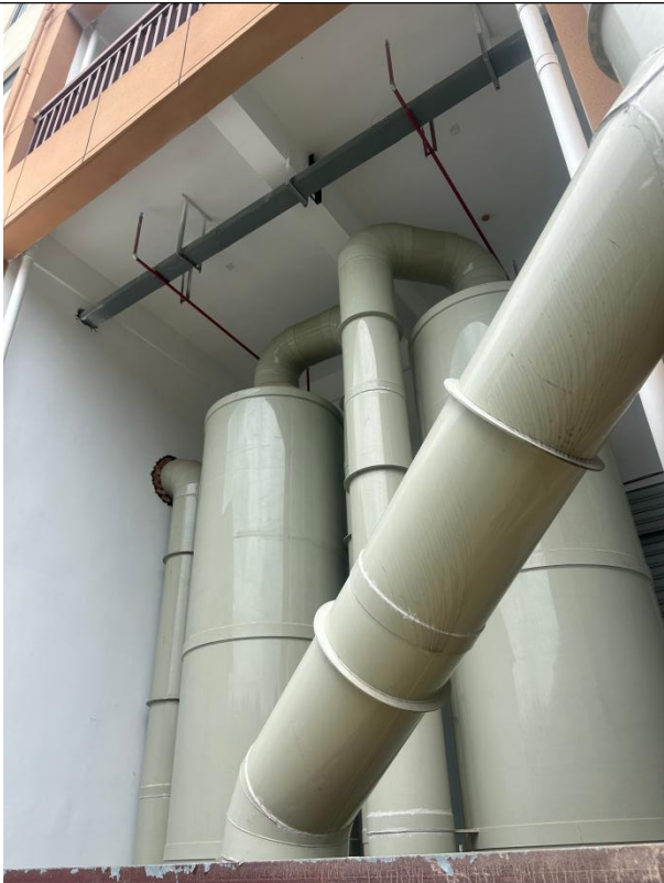
水喷淋塔+碱液喷淋塔
