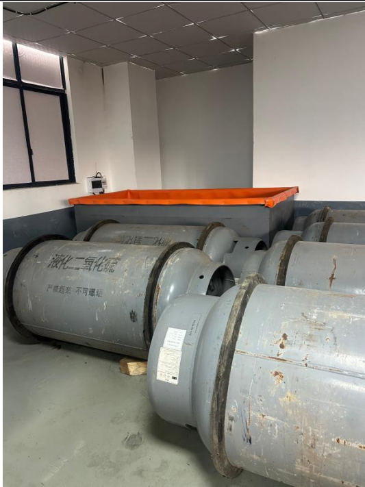
液化二氧化硫储罐及应急水槽
